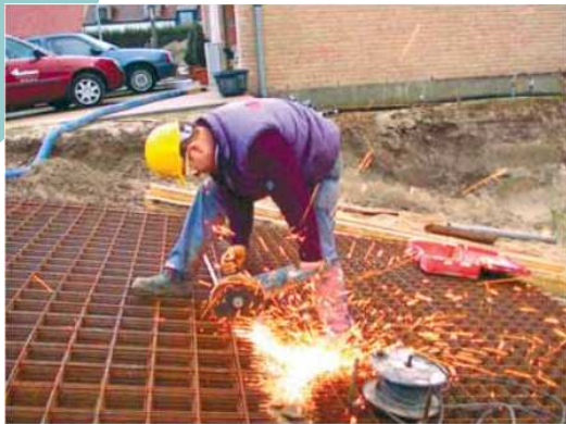
Conditions de travail dangereuses et inconfortables
